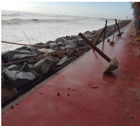
La zona de tanques i cordes també es va veure afectada
